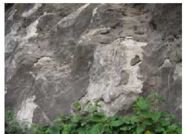
劣化したモルタル吹付工の補修として (施工前)
