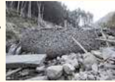
捕捉土石量 V=1,400m 3 高知県 北川村
