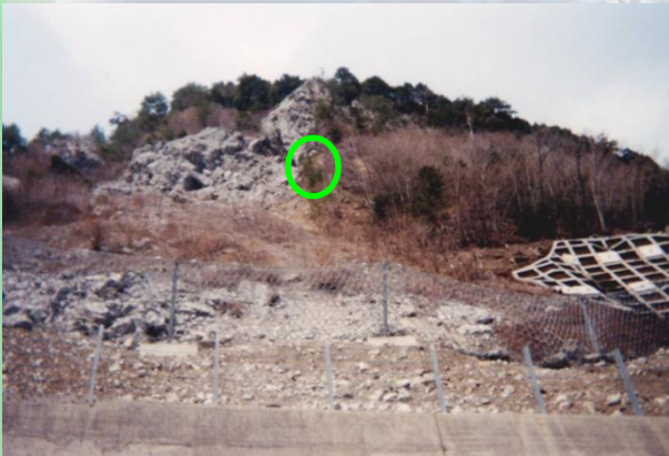
落石の推定発生源 〇位置 落石の推定落下高さ H=100m
