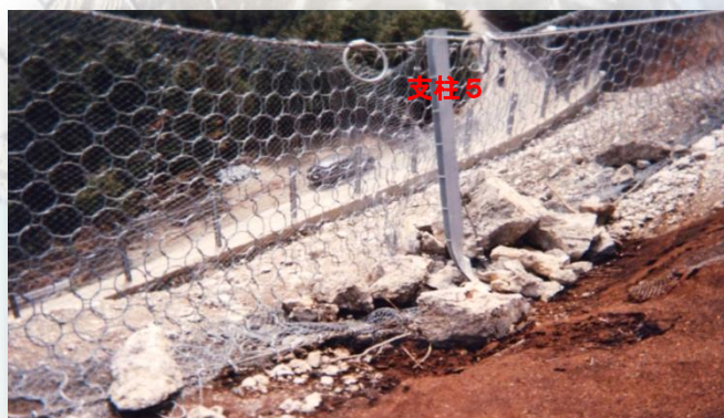
落石が集中したスパン(支柱5)
