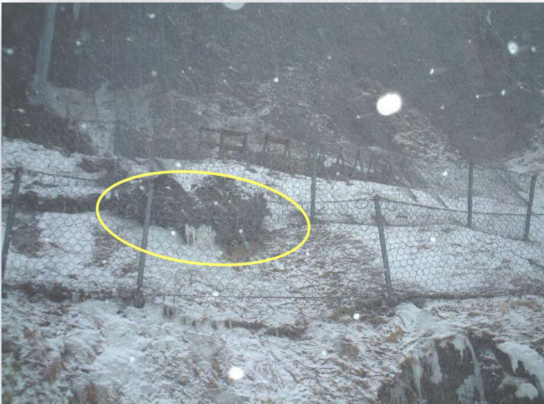
ロックネット背面からすり抜けた落石を捕捉
