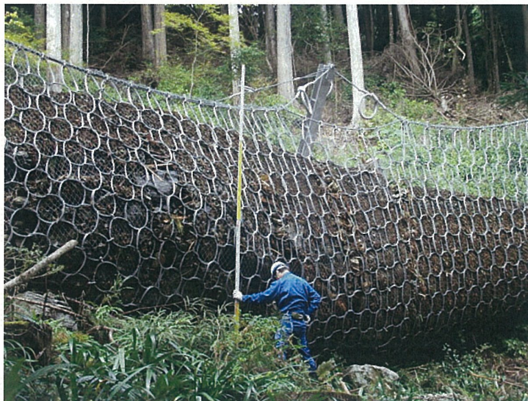
写真6.土石を捕捉したリングネット柵(奈良県)
